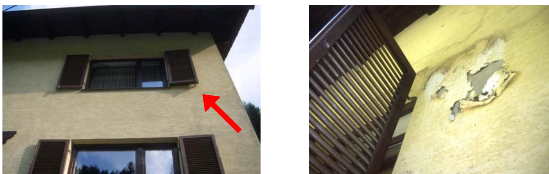
Abb. 4-42: Schäden an der Außenfassade durch den Urin und Kot einer Wochenstube der Mopsfledermaus hinter Fensterläden (Bad St. Leonhard, Kärnten, A). Fotos: M. Jerabek
