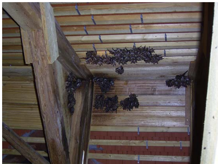
Abb. 4-24: Verbretterung im First in der Kirche Frichlkofen (Bayern, D). Durch die spaltenfreien Nut- und Federbretter (im First dicht geschlossen) wird ein Warmluftstau erreicht. Die Tiere hingen bereits im ersten Jahr an den neuen Brettern. Foto: A. Zahn
