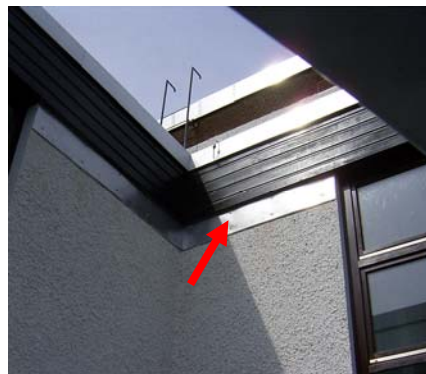
Abb. 4-30: ‚Fledermausabweiser‘ aus Blech zur Verhinderung des Einflugs der Abendsegler über den Hauseingängen (Wasserburg, Bayern, D). Foto: A. Zahn
