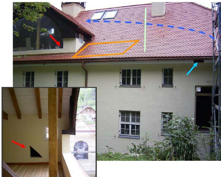
Abb. 4-7: Sanierung Kraftwerks- und Wohngebäude Aschau (Bayern, D). Situation nach dem Umbau 2004 (Ansicht der Gebäuderückseite). Grün: Grenze zwischen dem Wohnbereich (links) und dem Fledermausbereich (rechts). Gestrichelte blaue Linie: Früherer Flugweg zur Ein- und Ausflugsöffnung. Hellblauer Pfeil: Neue Öffnung, die den Tieren aus dem Vorjahr 2003 nicht bekannt war und die nicht genutzt wird. Rote Pfeile (großes und kleines Bild): Zusätzliche Öffnung an der Dachterrasse (hier bestand 2003 eine große Öffnung im Dach), die von den Tieren angenommen wurde. Orange: Toter Raum, der eine Flugwegverbindung zwischen der neuen Öffnung am Balkon und dem Fledermausbereich vorbei am Wohnbereich ermöglicht. Fotos: A. Zahn
